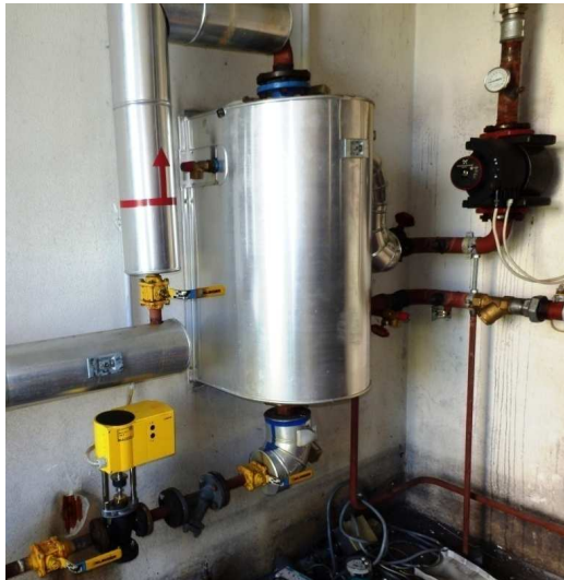
Abbildung 7: Fernwärme- Umformer im Technikraum
