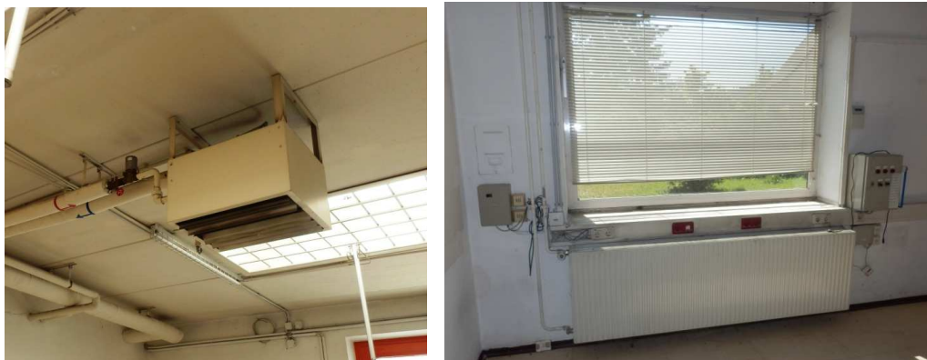
Abbildung 8: Lufterhitzer im Verkaufsraum u. Heizkörper im Büro
