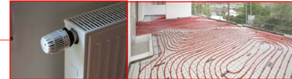
Neue Niedertemperatur Heizkörper mit Thermostatkopf, im TS Deckenstrahlplatten, im ganzen Kellergeschoss Fußbodenheizung
